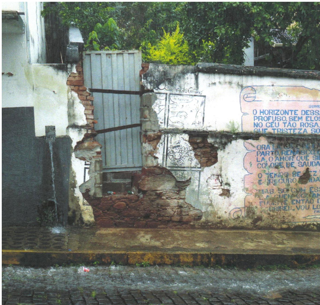
Estado atual do muro mostrado na capa do QI 106.
